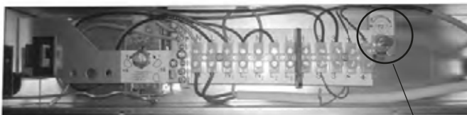
Poistoilmavirran potentiometri on sähköliitäntärasissa.
