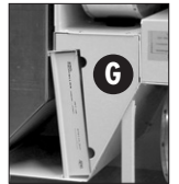
Etulämmityspatteri (G) Etulämmityspatteri sijaitsee suojan takana
