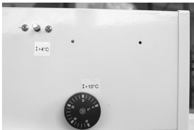
Vesipatterin jäätymissuojatermostaatin asetus
