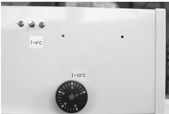
Vesipatterin jäätymissuojatermostaatin asetus
